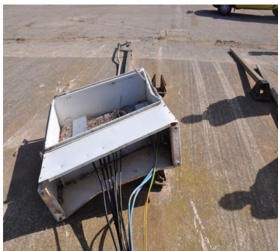
Foto 30: particolare della cabina elettrica.
